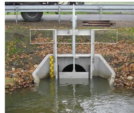
Kopfstück mit Schieber, Absturzicherung
