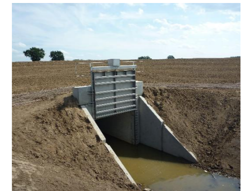
Auslaufbauwerk mit Schütztafel
